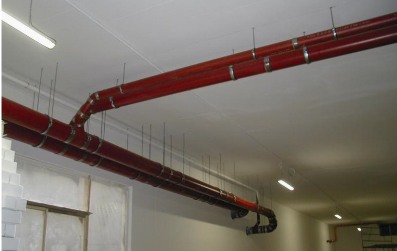
Sammelleitungen, Firma Düker
